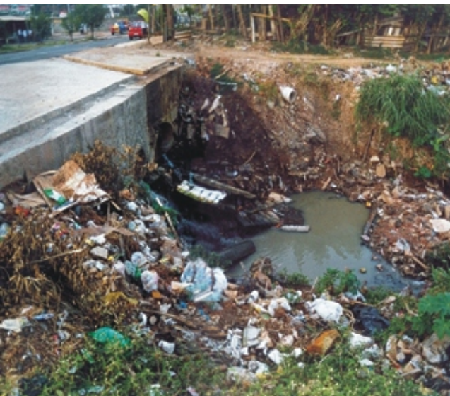
Impacto dos resíduos em sistemas de drenagem
